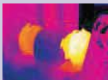
Перегрев крышки подшипника
