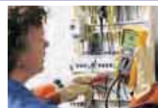
Проверка изоляции в распределительном щите
